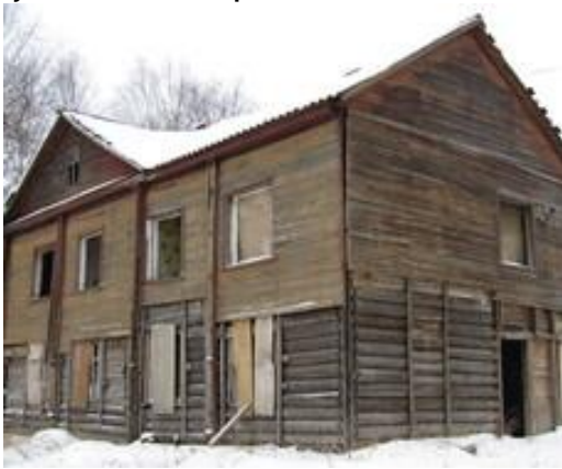
Аварийный жилой дом в Няндомском районе (фото с сайта https://www.reformagkh.ru )
